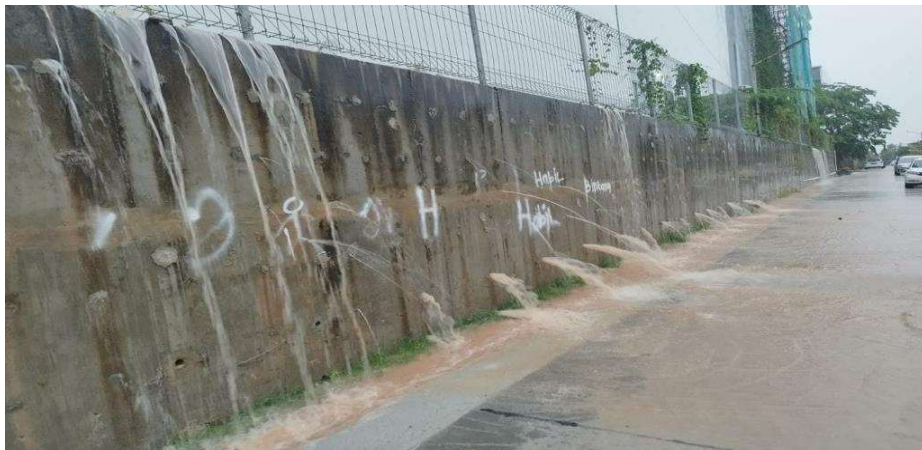
Gambar 1. 1 Kawasan Perumahan Citra Batam banjir, akibat pembangunan gedung Pollux Habibie Meisterstadt
