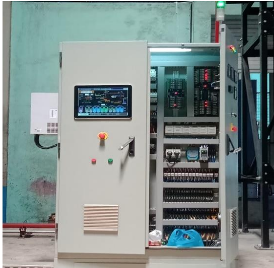
Gambar 2.9. Mesin pengontrolan Metode Insinerasi Sumber: Data Penelitian (2023)
