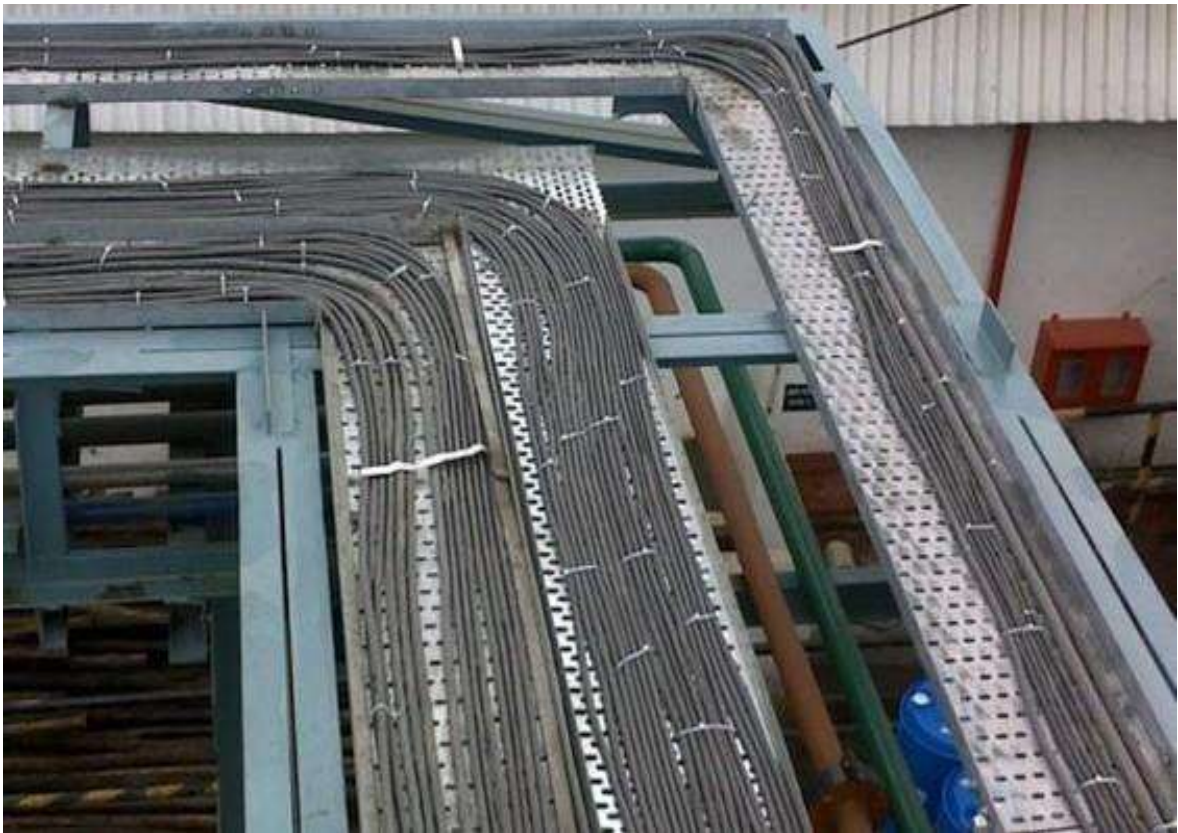
Gambar 2.4 Contoh Instalasi Kabel Tray (sumber:www.depopipa.com)
